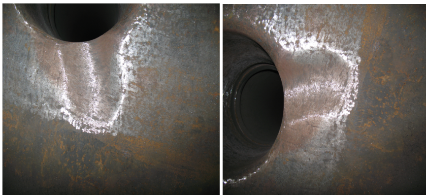
Rys. 1. Typowe poremontowe ubytki materiału w otoczeniu otworów w walczaku kotłowym konkretnego bloku elektrowni ciepłej.
